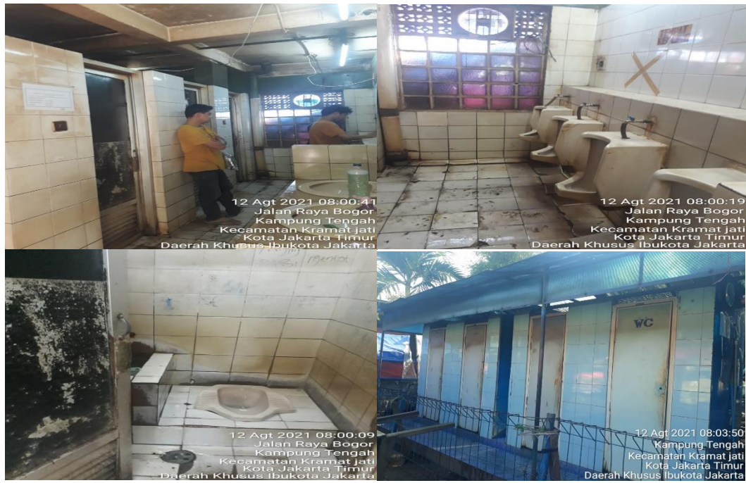
Gambar 4. Toilet Umum Pasar Sebelum Revitalisasi
