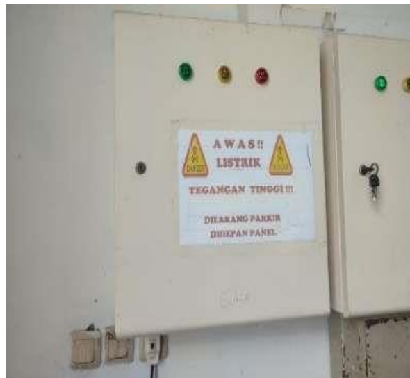
Gambar 4. Tanda Peringatan Listrik Tegangan Tinggi
