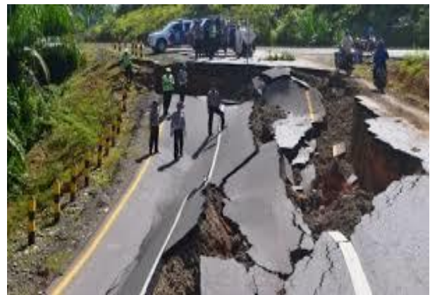
Gambar 2. Kerusakan Konstruksi Jalan yang Berada Diatas Tanah Gambut
