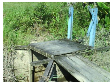
(3) Pintu Air di TR-27 dalam Kondisi Rusak Berat
