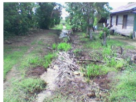
(2) Saluran Tersier-3 Tidak Berfungsi Dikarenakan Pengendapan Sedimen
