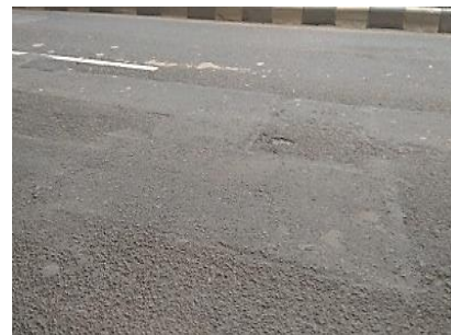
Gambar 7. Foto Kerusakan tonjolan dan lengkungan pada unit sampel 1.1.
