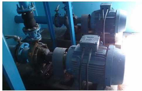
Gambar 5.12 Pompa distribusi jenis Sentrifugal (Dokumentasi Lapangan)
