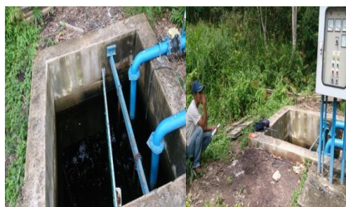
Gambar 5.3 intake air baku (Dokumentasi Lapangan)
