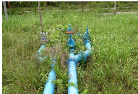
Gambar 5.13 Pipa Distribusi (Dokumentasi Lapangan)
