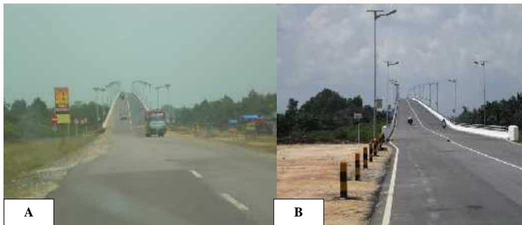
Gambar 5. A). Kondisi kenampakkan jalan di jembatan daerah tualang. B). Kondisi setelah diperbaiki tetap memperlihatkan adanya pergeseran.
