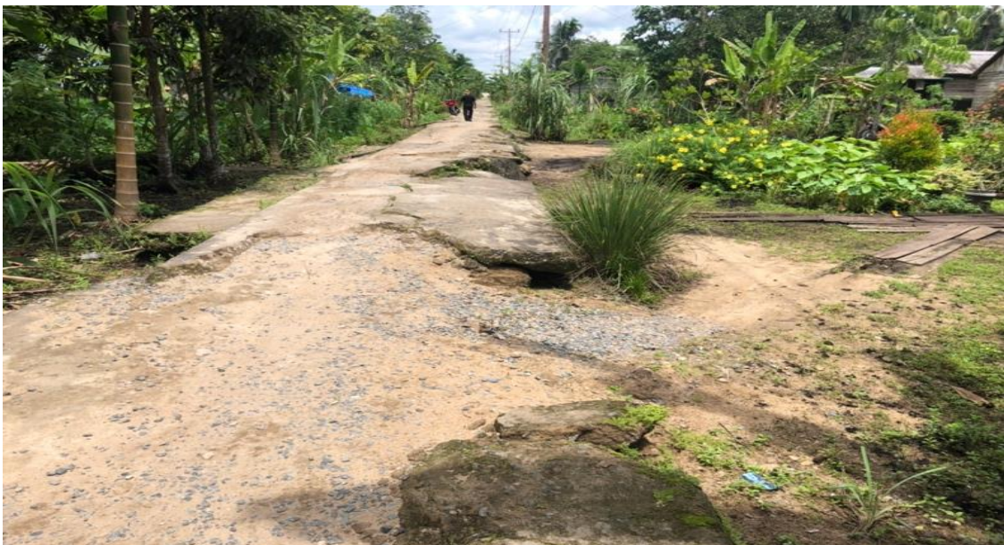
Gambar.1. Kondisi Jalan Rusak di Kecamatan Enok
