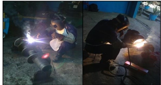
Gambar 3 Perbaikan Yang Dilakukan Dengan Cara Pengelasan. (sumber: PT.SSA)
