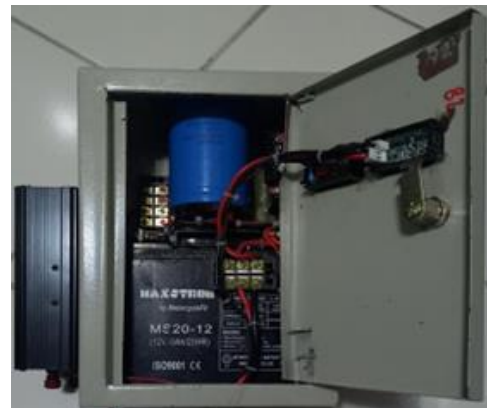
Gambar 10. Panel kontrol PLTGL
